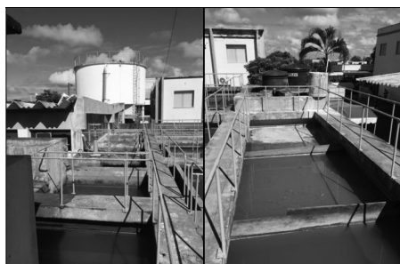
Figura 12 – Floculadores - ETA's 1 e 2 Fonte: Premier Engenharia, 2019.
