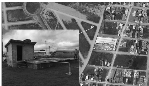
Figura 17 – Reservatório Parque das Brisas Fonte: Premier Engenharia, 2019.
