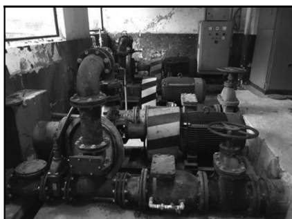
Figura 8 – Conjuntos motobomba - EEAB Fonte: Premier Engenharia, 2019.
