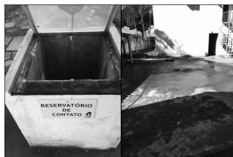
Figura 15 – Tanque de Contato Fonte: Premier Engenharia, 2019.
