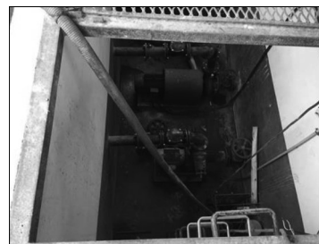
Figura 21 – ERAB - Poço em operação Fonte: Premier Engenharia, 2019.
